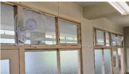
各クラスに増設された壁掛け型扇風機
